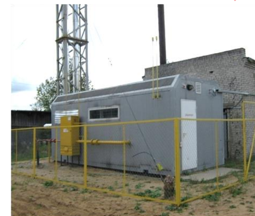
Приобретение блочно-модульной газовой котельной для МБУК «КДЦ СП Верховское»
